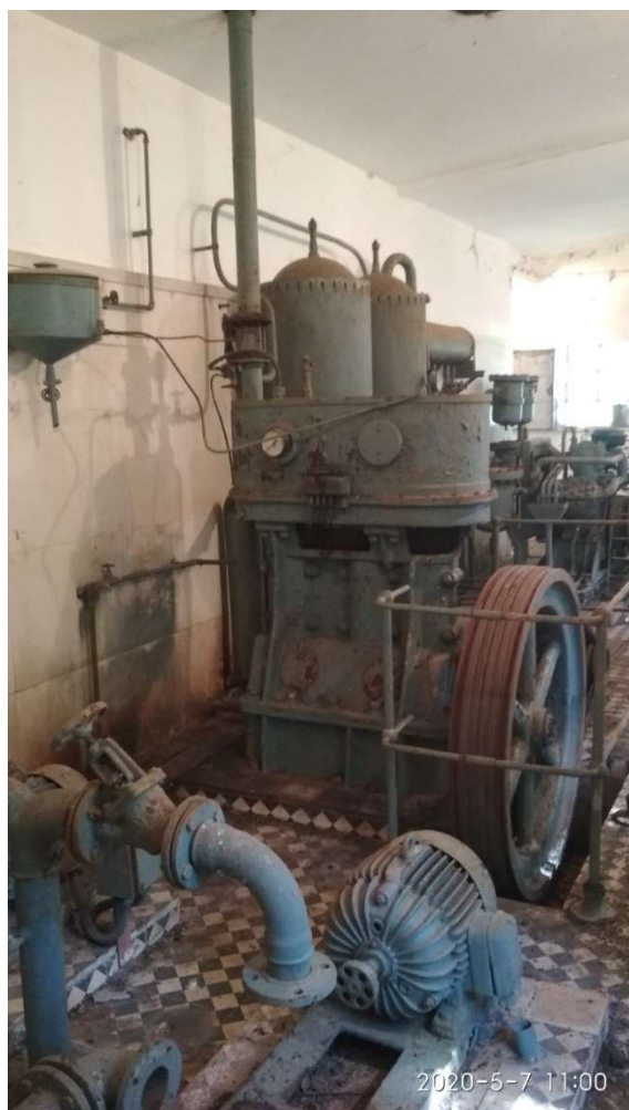
Pumpa sa zamašnjakom, sistemom cijevi
